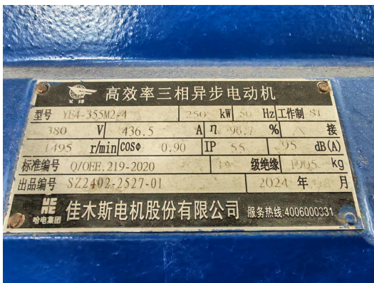
工频循环水泵
