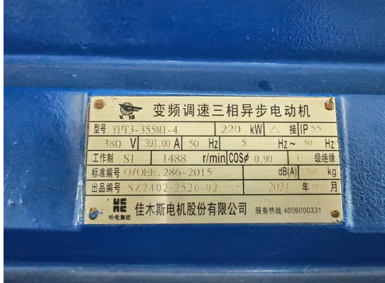
循环水变频泵
